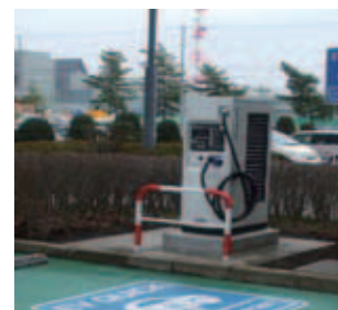
急速充電器（県庁第二庁舎）
